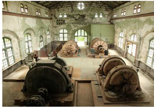
旧端出場水力発電所内 発電設備
