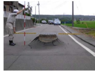
液状化現象によるマンホール隆起 （国土交通省ホームページより引用）
