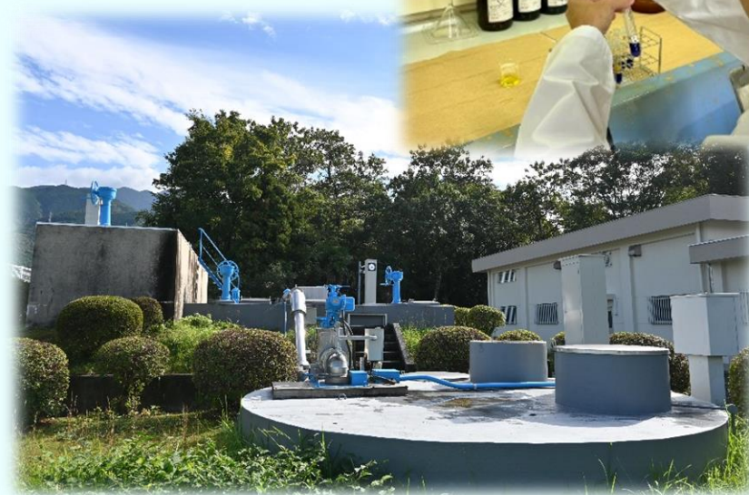
〈吉岡水源地の大井戸(上部給水区)〉
