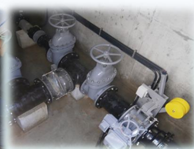
〈緊急遮断弁（新山根配水池）〉
