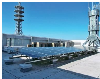
太陽光発電設備の導入 (消防防災合同庁舎等)
