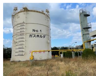
消化ガスの有効利用 (下水処理場)
