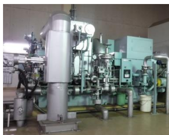
廃棄物発電 (清掃センター)
