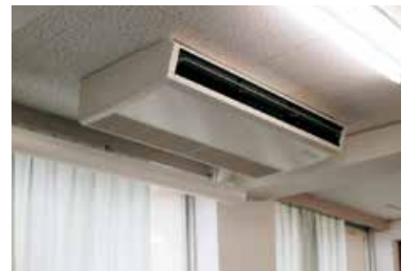
小中学校空調整備事業 14 億 8,701 万円 小学校の普通教室および特別教室に空調機器を設置しました。
