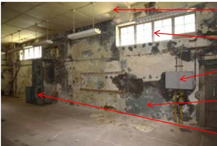
配電盤室 東面
