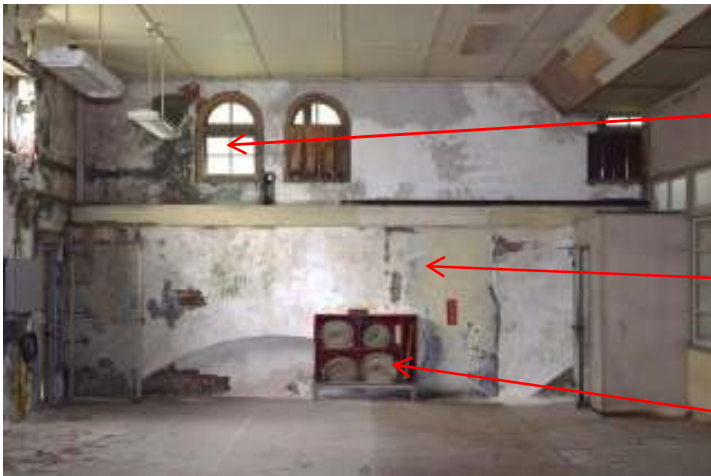
配電盤室 南面
