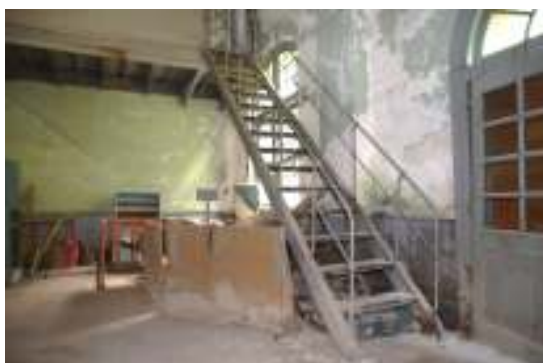
写真 3-16 配電盤室 2階へ上がる階段
