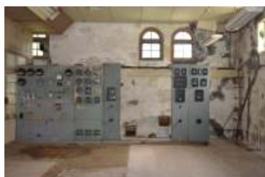
写真 3-17 第二水車発電機の監視盤
