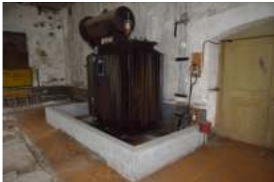
写真 3-12 回轉變流機用変圧器
