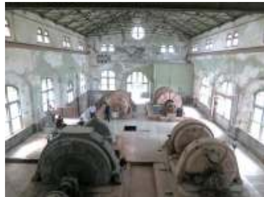
写真 3-7 2 階配電盤室からタービン室を望む
