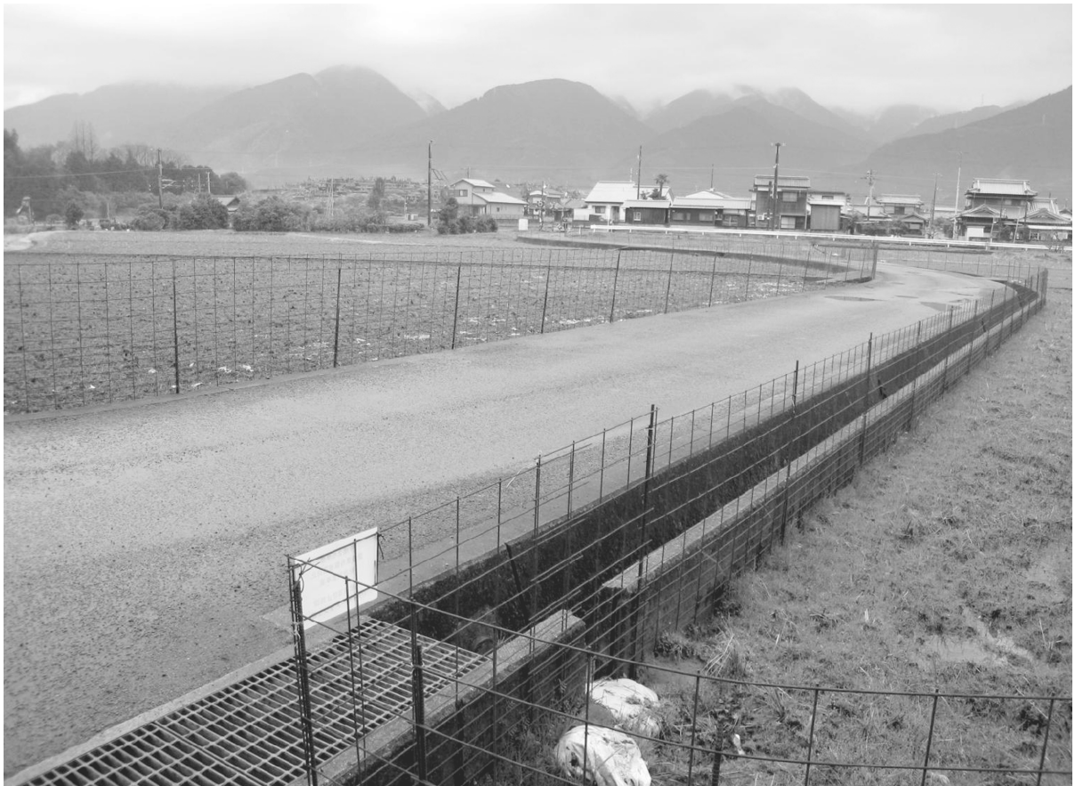
愛媛県鳥獣被害防止総合対策事業 鳥獣被害防止施設(ワイヤーメッシュ柵) 施行箇所 大生院
