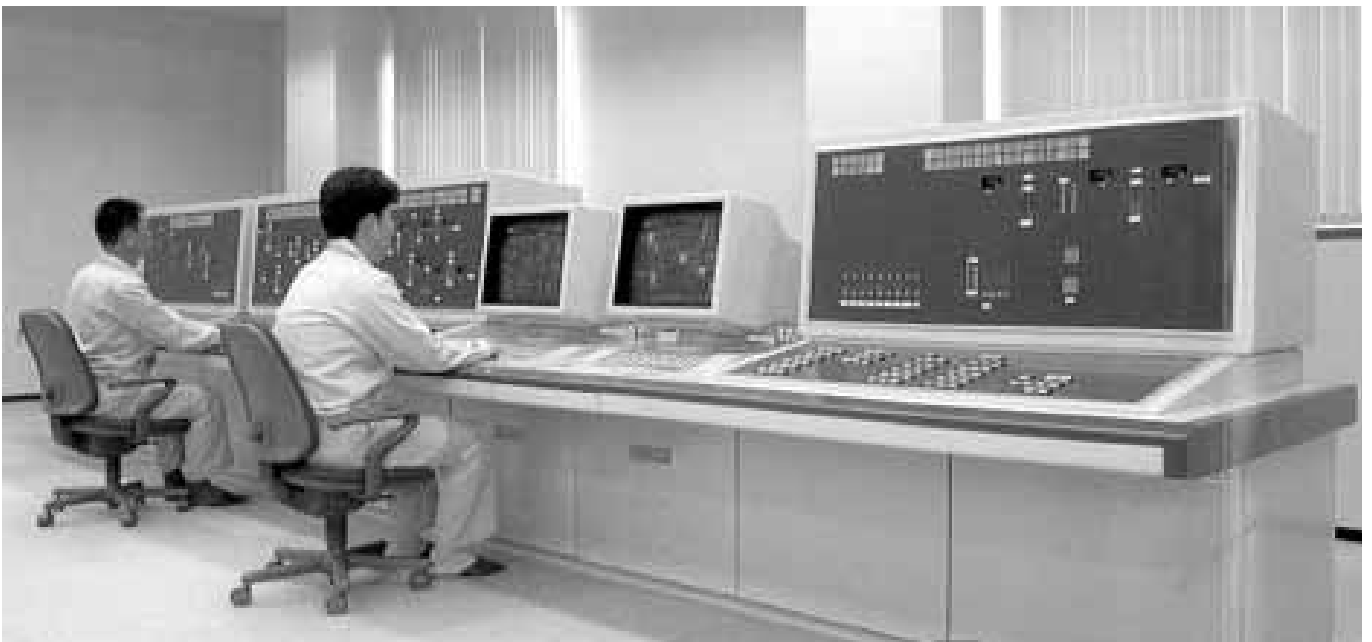
上水道集中監視システム制御室
